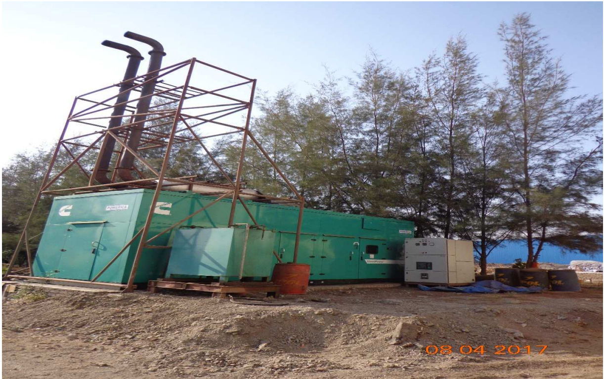
DG- Set – 700 KVA
