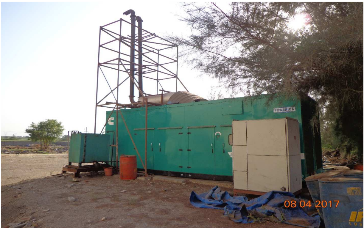
DG- Set – 700 KVA
