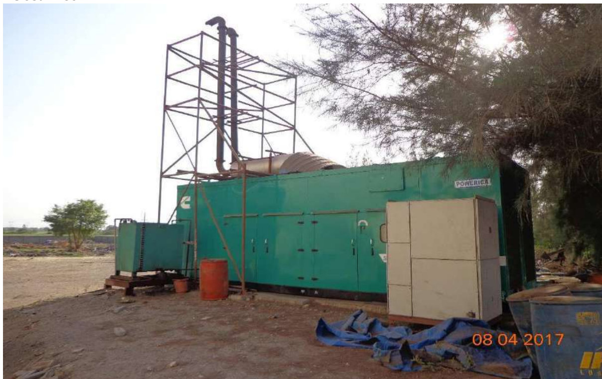
DG Set – 750 KVA
