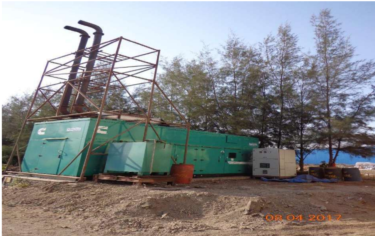
DG Set – 750 KVA
