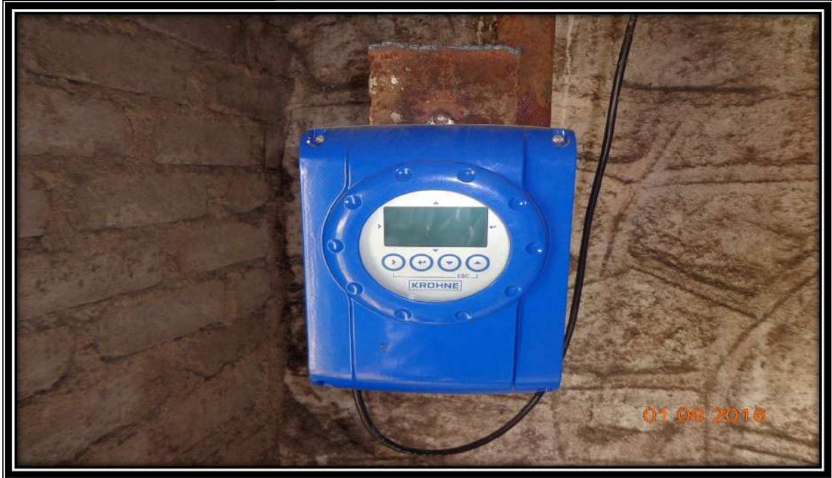
Flow meter Display
