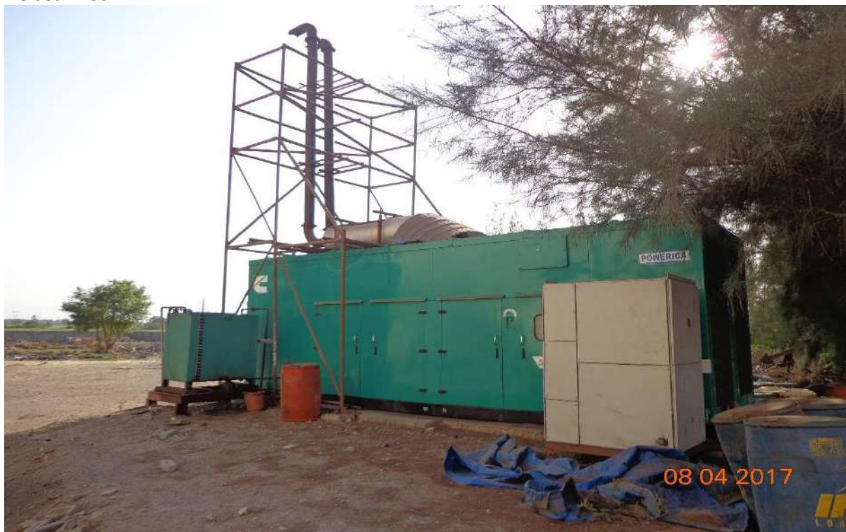
DG Set – 750 KVA
