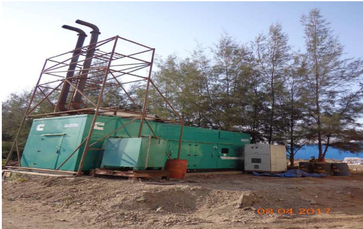
DG Set – 750 KVA
